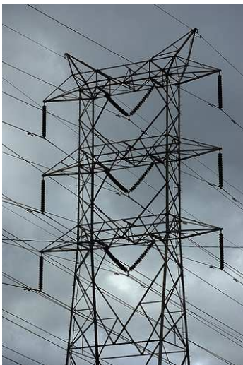
Torre alta tensión.
